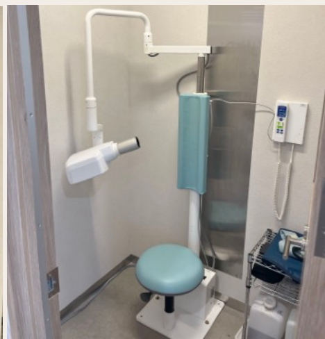
デンタル用レントゲンルーム
